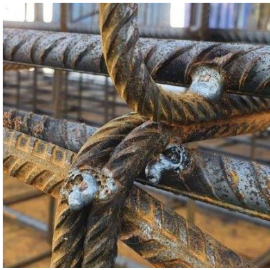
Porosités et diminution de la section de l'armature longitudinale
