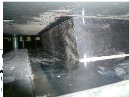
Décollement de l'interface
