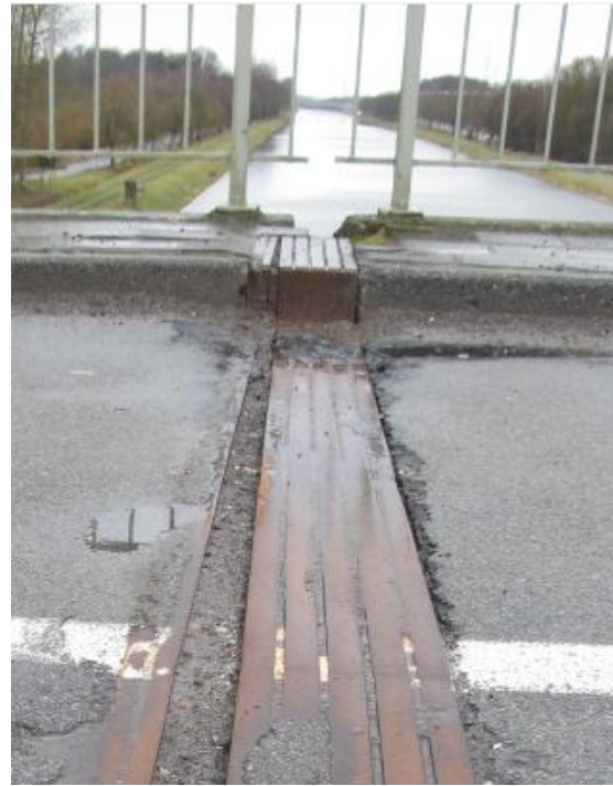
FIGURE 47 : PAS DE MOUVEMENT OBSERVÉ EN AVAL AU NIVEAU DU JOINT
