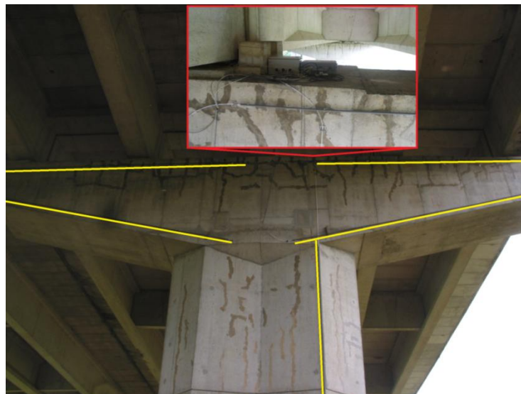
FIGURE 17 : INSTRUMENTATION D'UN CHEVÊTRE À L'AIDE DE FIBRES OPTIQUES
