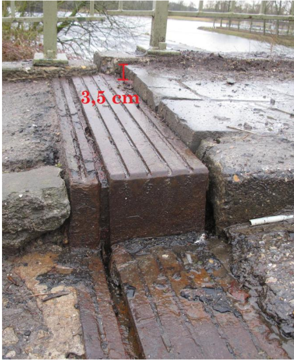
FIGURE 48 : MOUVEMENT VERTICAL AU NIVEAU DU JOINT DE 3,5 CM EN AMONT
