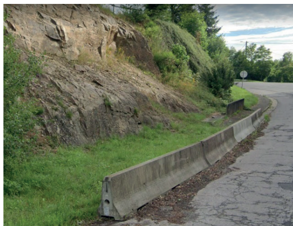
Figure 6. Dispositif de retenue en béton le long de la N4e à Martelange.
