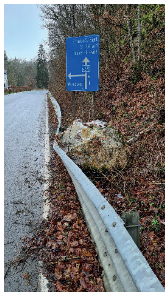
Figure 7. Dispositif de retenue en acier le long de la N971 à Denée, impacté par un rocher en 2023.
