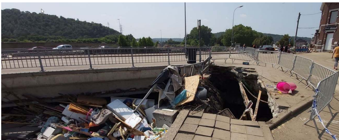
- Important affouillement au droit de la culée en rive droit du pont de Lhonneux à Chênée -
