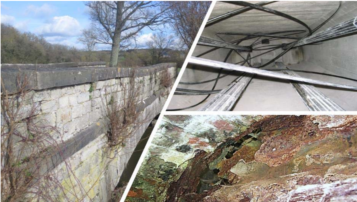
Exemples de défauts répertoriés sur des ouvrages communaux
