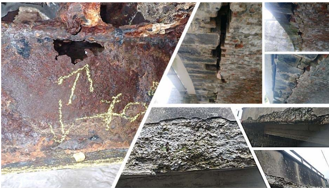
Exemples de défauts observés en deuxième phase
