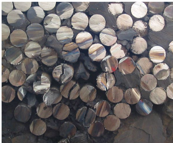
Fissuration radiale des fils après découpe du câble
