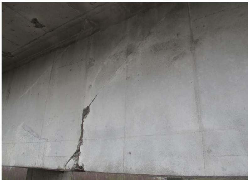
Vue de la fissure après dégagement sur la poutre extérieure de la travée 9
