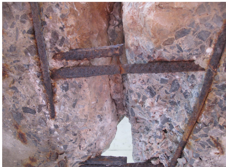
Armatures passives rompues en face inférieure de la poutre extérieure
